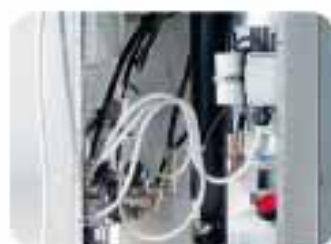
4. Particolare centralina e comandi elettrici Electric station and controls
